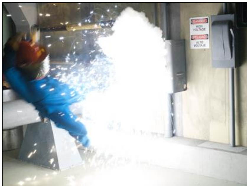
Obr. 3: Emise světla a šíření tlakové vlny při Arc-Flash [6].
