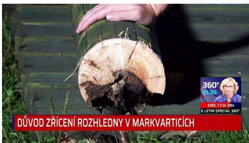
Obr 1. Míra degradace nosných prvků plošiny rozhledny v Markvarticích [15].
